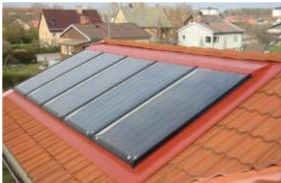
LESOL 5 AR, 8 m 2 , 5 moduler, 750 L soltank och pelletseldning hos Krister Jonsson i Köping. Pelletseldningen och VP avstängd maj – sept.
