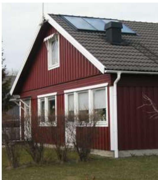
Solfångare för tappvarmvatten i Arboga. 4,8 m 2 LESOL 5 AR (3 moduler) kopplade till en 300 liters varmvattenberedare OSO 300 liter i rostfritt stål. Beredare och drivpaket får plats i grovköket. Solen ger minst halva årsbehovet av varmvatten till en 4-personersfamilj.
