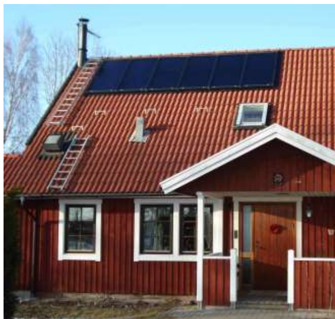
Kombianläggning 9,6 m 2 LESOL 5 AR (6 moduler) kopplade mot sol- och vedtank 2 500 liter. Solvärme och vedeldning ger mycket låg uppvärmningskostnad. Malte Askvik, Stora Sundby.
